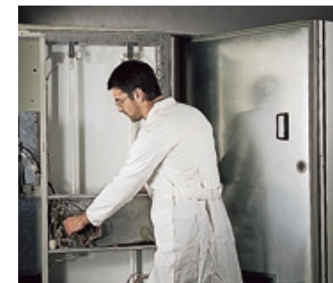
Contrapuerta cerrada sobre el mueble durante las operaciones de mantenimiento y programación
